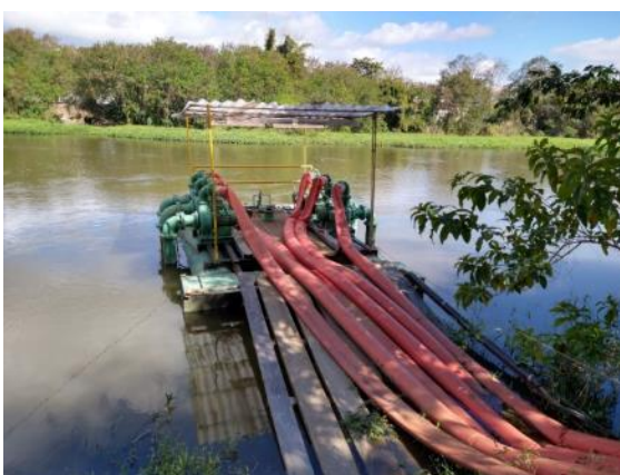
Figura 5 - Vista da captação auxiliar flutuante mais antiga e dos mangotes flexíveis de adução até o poço de sucção da captação principal
