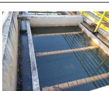
Figura 12 - Decantador de alta taxa com destaque para os módulos lamelares submersos e as tubulações perfiradas de coleta de água decantada
