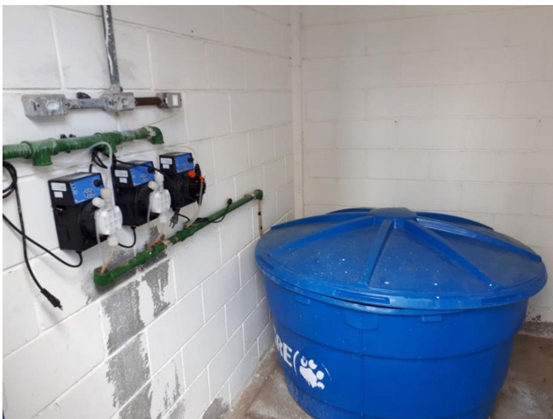
Figura 36 - Sistema de armazenamento e dosagem de hipoclorito de sódio
