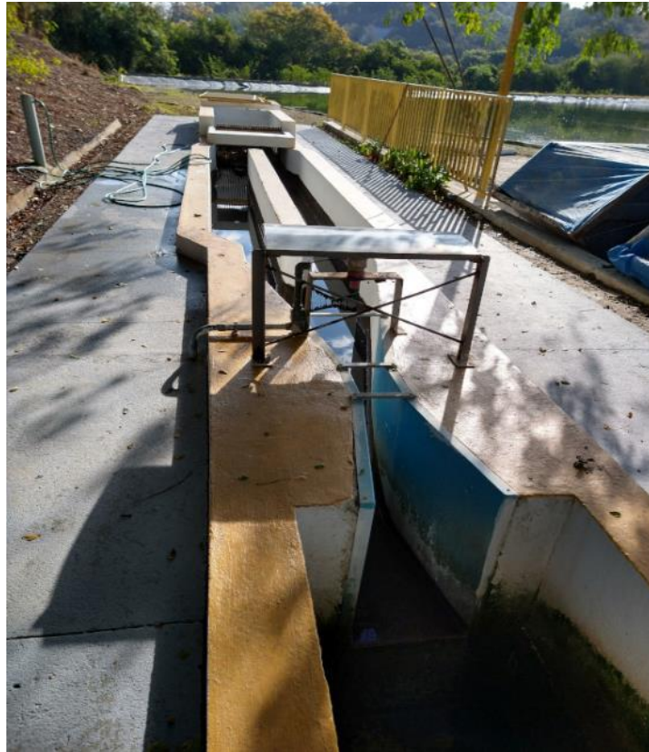
Figura 27 - Vista do tratamento preliminar. Em primeiro plano, calha Parshall e ao fundo caixas de areia e grade
