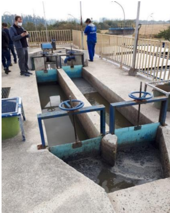
Figura 29 - Vista do tratamento preliminar. Em primeiro plano, caixas de areia e, ao fundo, gradeamento
