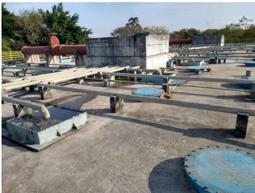
Figura 23 - Laje de cobertura de um reator UASB com destaque para as caixas de distribuição de fluxo de alimentação e inspeções
