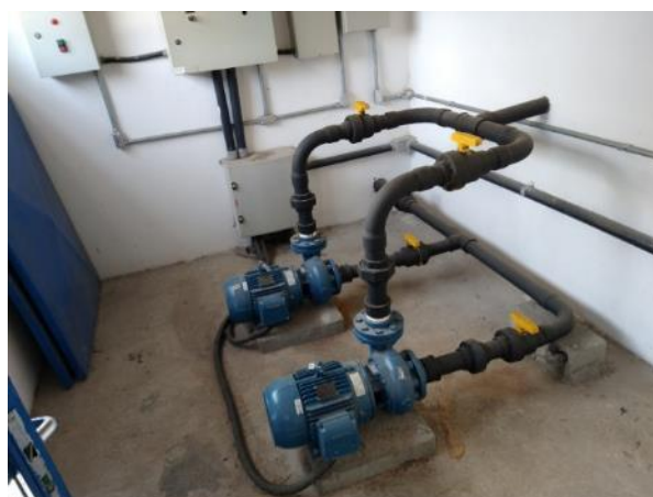
Figura 26 - Vista interna da estação elevatória de recirculação e descarte de lodo ativado
