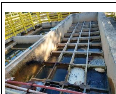
Figura 11 - Vista geral dos flo-culadores hidráulicos, à direita, e decantadores, à esquerda
