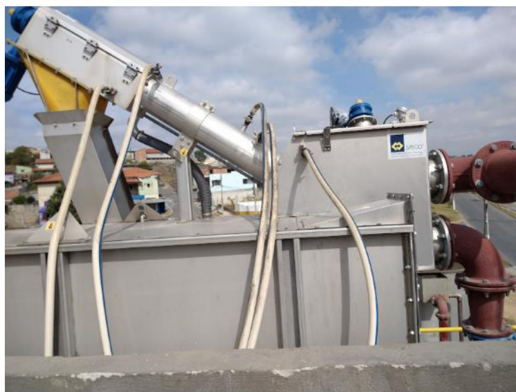
Figura 34 - Vista da estação compacta de tratamento preliminar, peneira e caixa de areia de limpeza mecanizada.
