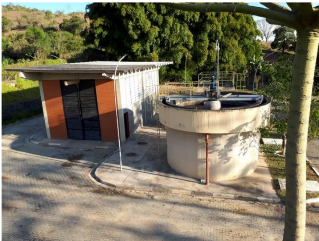
Figura 33 - Vista do adensador gravimétrico de lodo descartado e prédio do sistema de desaguamento
