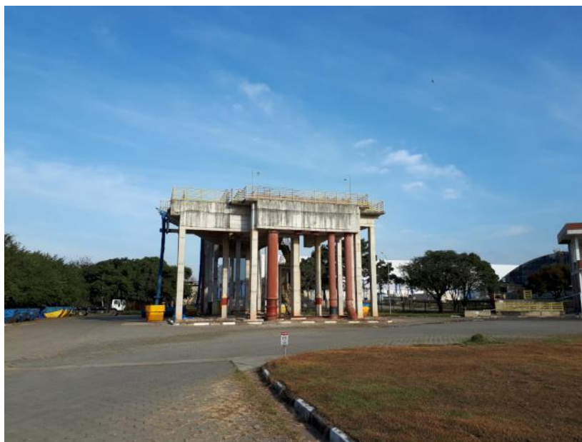
Figura 22 – Vista geral da unidade de tratamento preliminar
