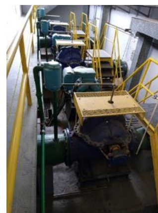
Figura 6 - Vista do poço seco e conjuntos moto-bomba, do tipo bipartidos, da captação principal
