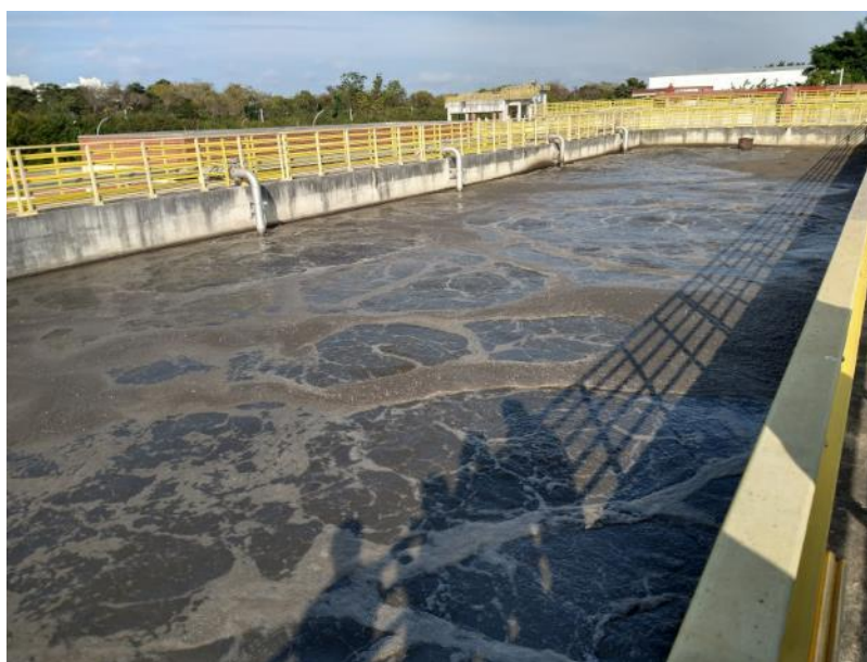
Figura 24 - Vista de um dos Tanques de Aeração do Estágio de Lodos Ativos
