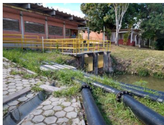
Figura 4 - Vista dos tubos rígidos de PEAD de adução da captação auxiliar mais nova até o poço de sucção da captação principal
