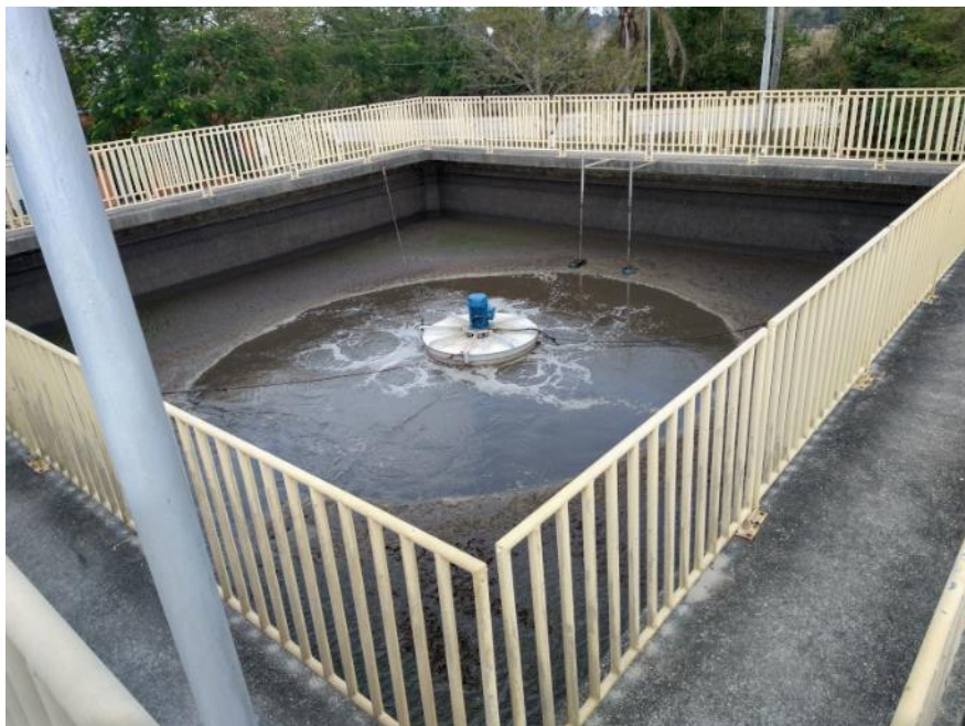
Figura 30 - Vista de um dos tanques de aeração / decantação com destaque para o aerador mecânico flutuante em operação
