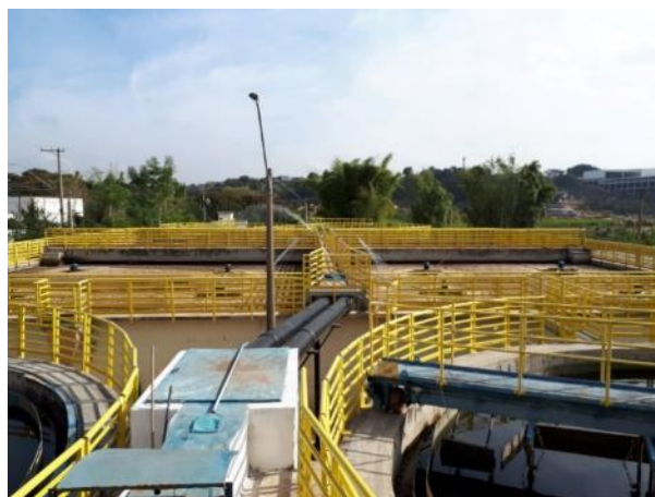
Figura 25 - Vista geral do sistema de lodos ativados. Em primeiro plano decantadores secundários e ao fundo tanques de aeração
