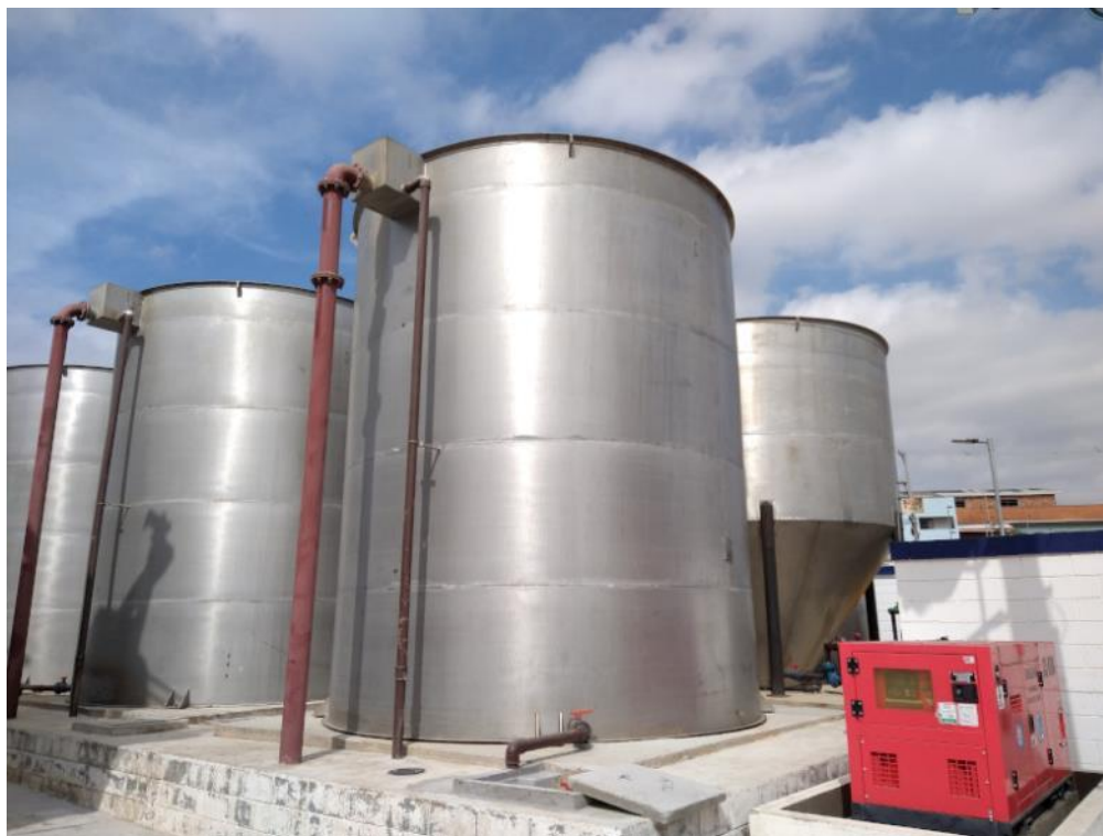
Figura 35 - Em primeiro plano, tanques de aeração e no segundo plano decantadores secundários. A direita, gerador destinado à eventual energização da EE de chegada do esgoto bruto
