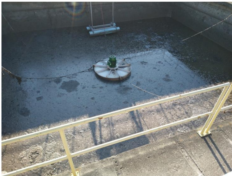
Figura 32 - Vista de um dos tanques de aeração/decantação. Destaque para o aerador mecânico superficial e para a estrutura flutuante de coleta de sobrenadante
